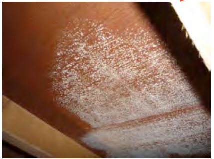
居間下の床板（合板）に白色腐朽菌がみつかった。居間は数年前にリフォームし、合板を下地にして、無垢の檜を張っている
