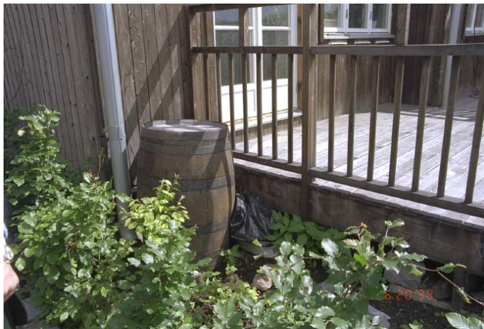
雨水貯溜タンク
